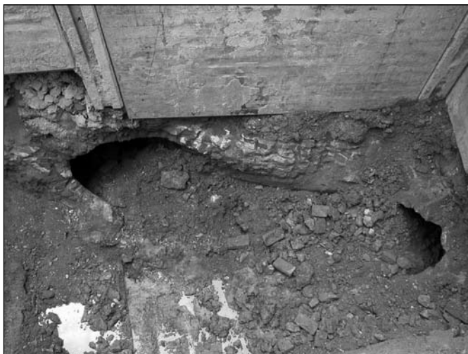
10. kép: Átlós irányú alagút bontása a munkaárok 3. és 4. akna közötti szakaszán, az Ybl-szobor vonalában Fig. 10: Section of an 'unknown' tunnel crossing the trench of the Main Sewer diagonally, found close to the Ybl statue
