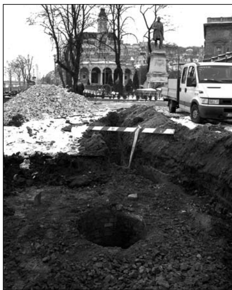
11. kép: Kábelárók ásása közben előbukkant téglakürtő az Ybl Miklós téren Fig. 11: Well-like funnel found meanwhile digging trenches for cables beside the Main Sewer's trench, Ybl Miklós tér, middle part
