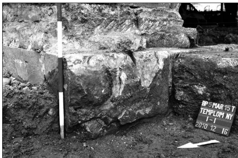
3. kép: A nyugati homlokzat előtti támpillér lábuzatán látható újkori vakolat és festés Fig. 3: The modern age plaster and paint on the pillar base on the western facade
