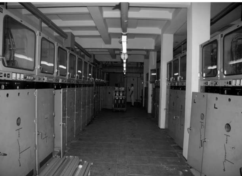
Az ELMŰ épület kapcsolóterme
